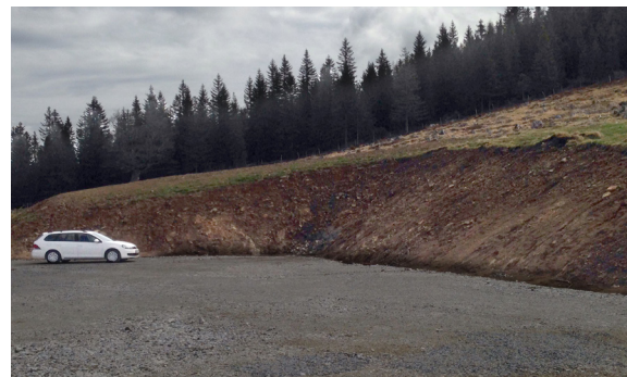
Fehlende Humusierung, fehlende Begrünung
